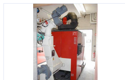
Chaudière pilote instrumentée (200kW)
